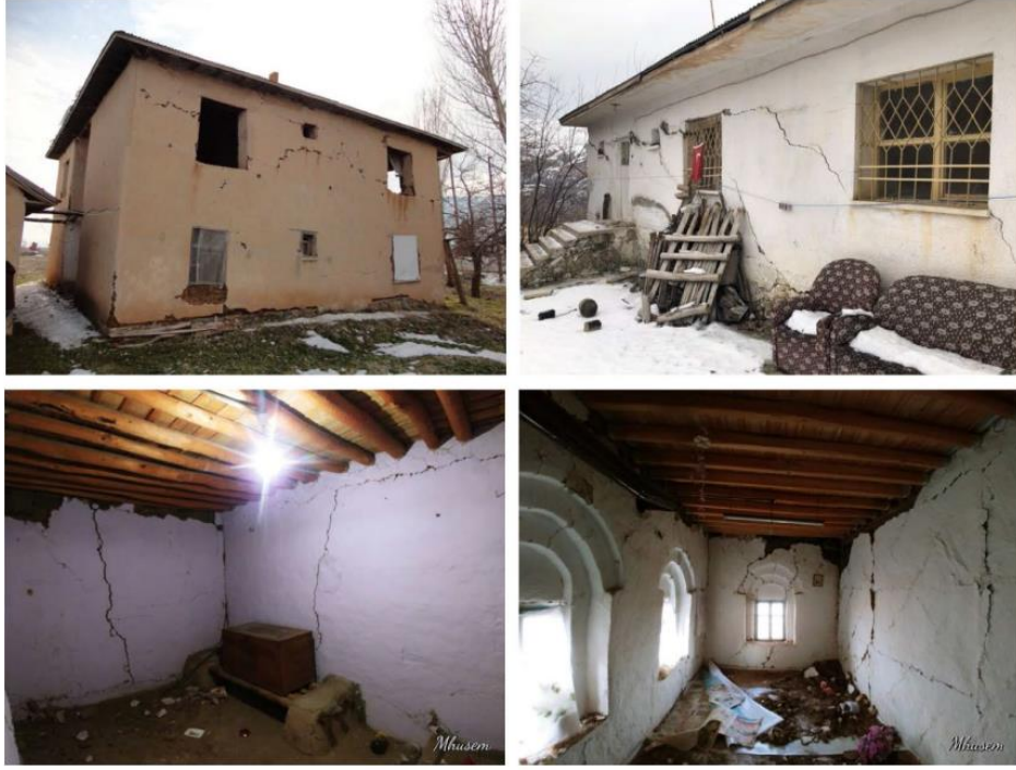
Şekil 71. 24 Ocak 2020 Sivrice (Elazığ) depreminde tespit edilen duvar hasarları [26]
