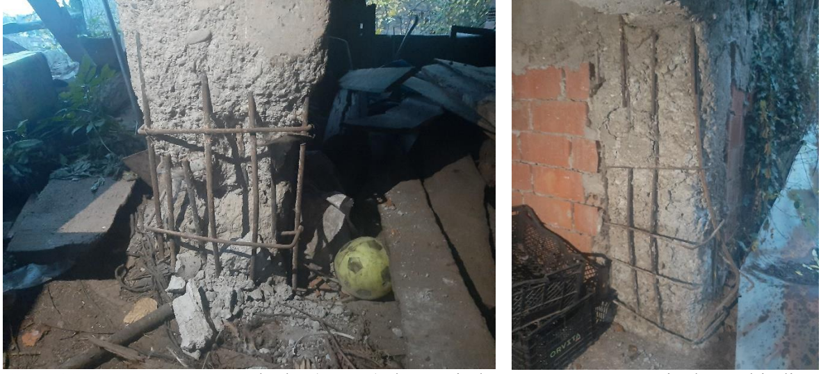
Şekil 41. 23 Kasım 2022 Gölyaka (Düzce) depreminde tespit edilen yetersiz donatı bindirme boyları
