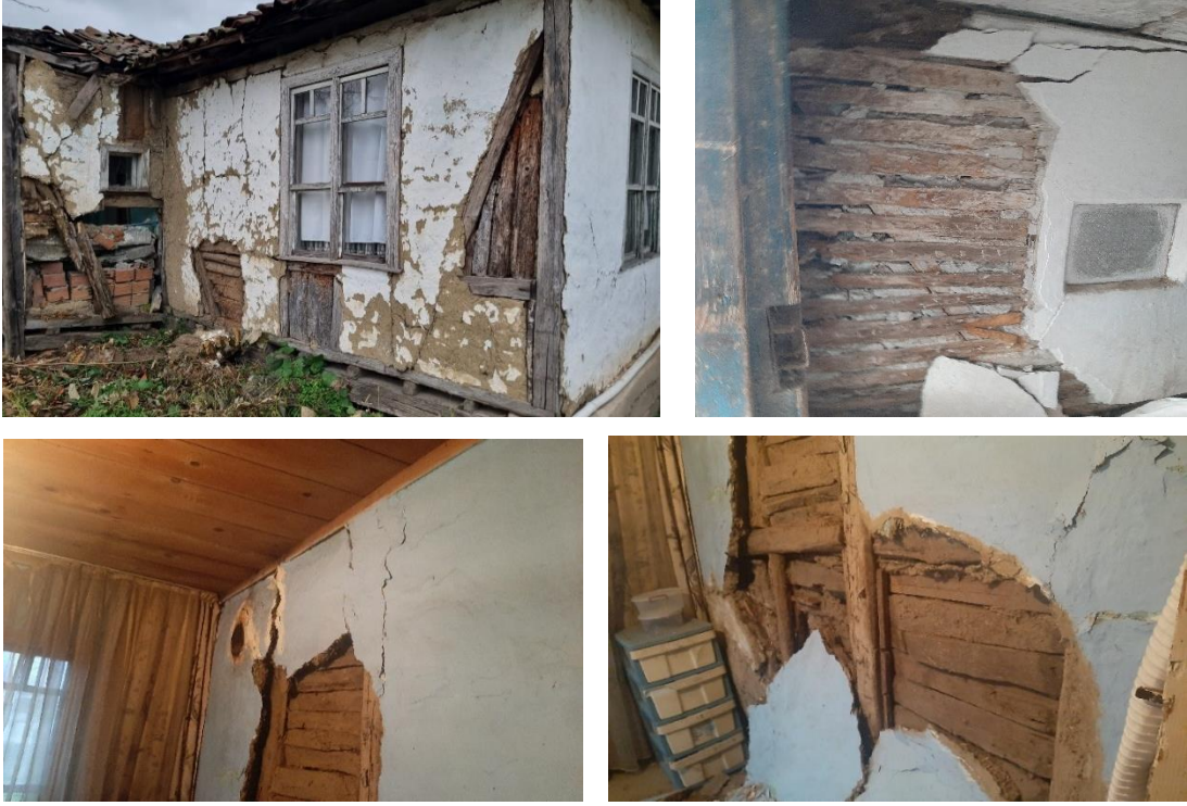
Şekil 64. 23 Kasım 2022 Gölyaka (Düzce) depreminde düşük mukavemetli kerpiç birimlerinde oluşan dikey çatlak hasarları
