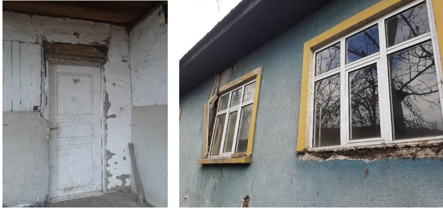
Şekil 68. 23 Kasım 2022 Gölyaka (Düzce) depreminde yetersiz lento boyu nedeniyle oluşan hasarlar
