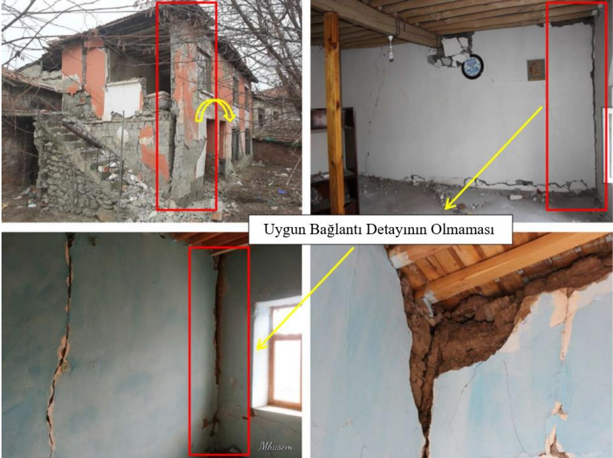
Şekil 59. 24 Ocak 2020 Sivrice (Elazığ) depreminde dikey duvarlarının birleşim bölgelerinde uygun bağlantı detayının yapılmaması nedeni ile oluşan hasarlar [26]
