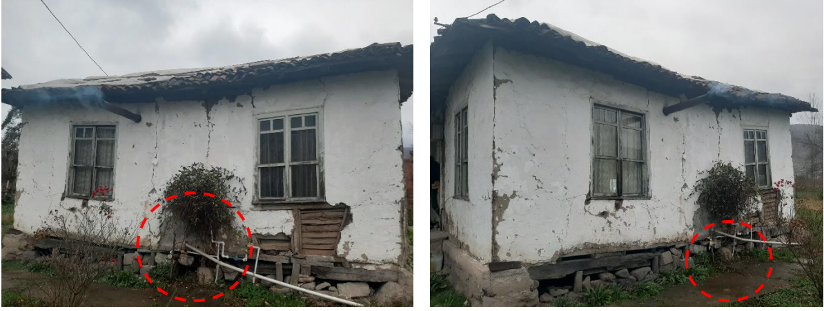
Şekil 72. 23 Kasım 2022 Gölyaka (Düzce) depreminde temel hareketinden kaynaklı hasarlar
