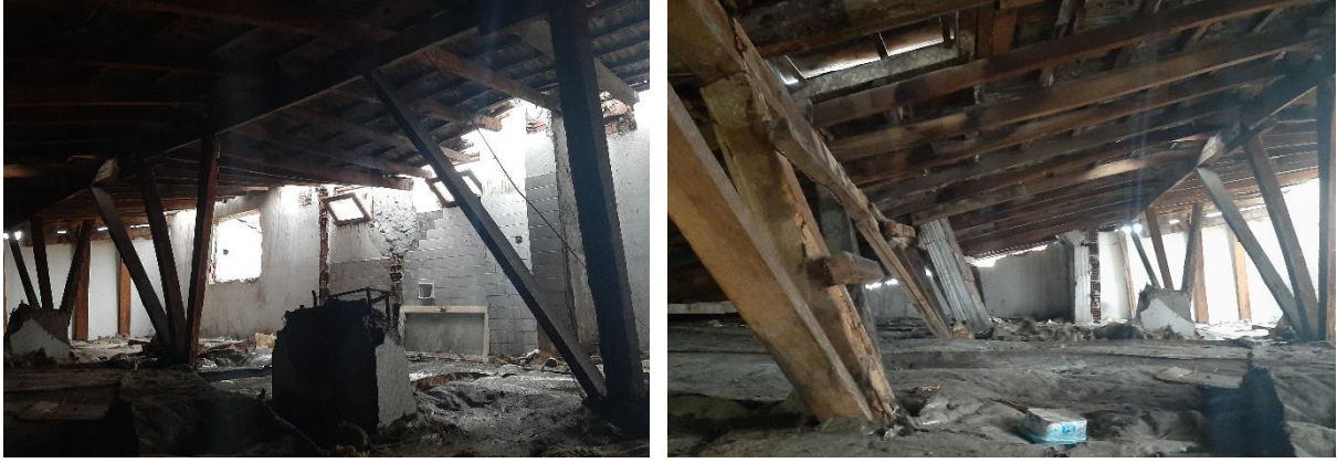
Şekil 56. 23 Kasım 2022 Gölyaka (Düzce) depreminde zayıf kalkan duvarlarında oluşan hasarlar
