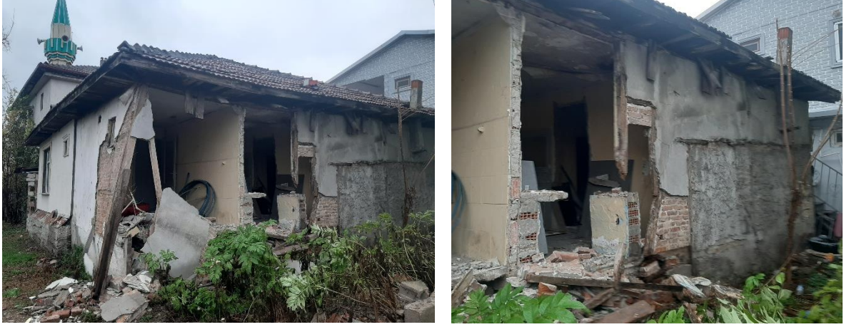
Şekil 58. 23 Kasım 2022 Gölyaka (Düzce) depreminde dikey duvarlarının birleşim bölgelerinde uygun bağlantı detayının yapılmaması nedeni ile oluşan hasarlar
