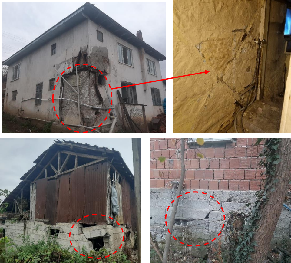
Şekil 65. 23 Kasım 2022 Gölyaka (Düzce) depreminde düşük mukavemetli yığma birimlerinde oluşan dikey çatlak hasarları
