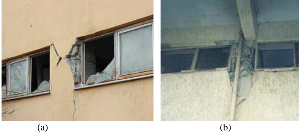
Şekil 33. (a) 24 Ocak 2020 Sivrice (Elazığ) [16] ve (b) 17 Ağustos 1999 [17] Kocaeli depreminde tespit edilen kısa kolon oluşumuna bağlı yapısal hasarlar
