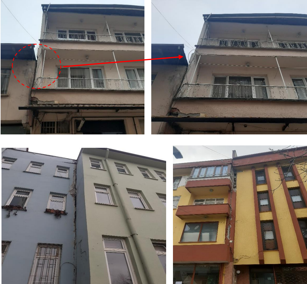
Şekil 35. 23 Kasım 2022 Gölyaka (Düzce) depreminde gözlemlenen yetersiz derz boşluğuna bağlı çarpışma sonucunda oluşan yapısal hasarlar
