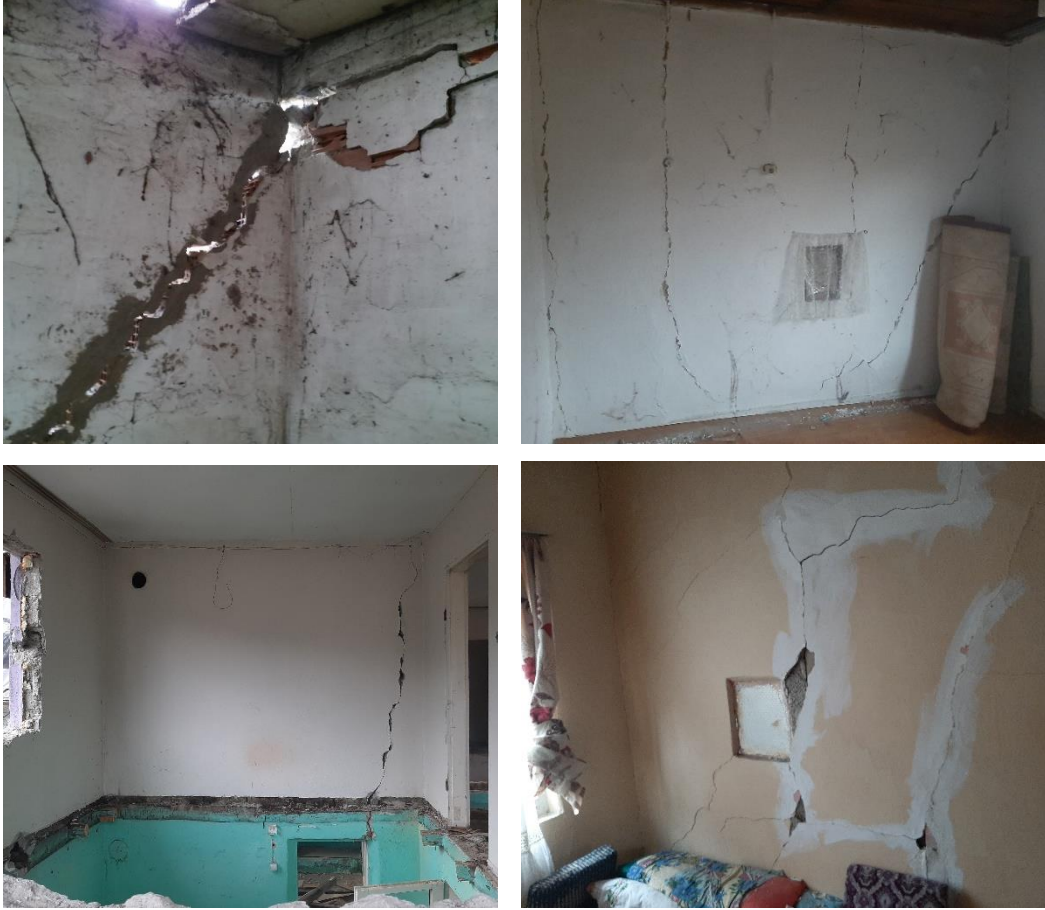
Şekil 70. 23 Kasım 2022 Gölyaka (Düzce) depreminde oluşan duvar hasarları
